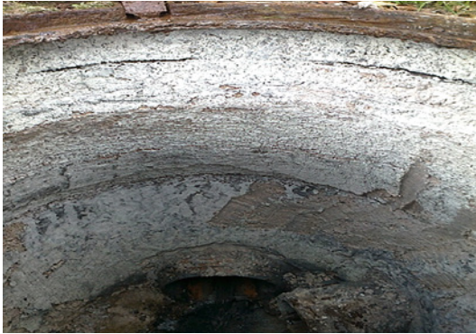
4. att. Sulfātu izraisīta betona korozija.
