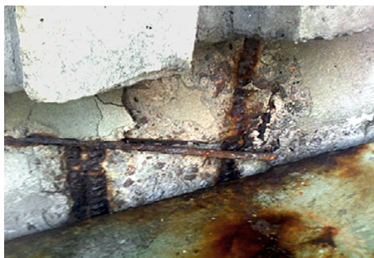
2. att. Dzelzsbetona ķīmiskā korozija (Vanšu tilts, Rīga).
